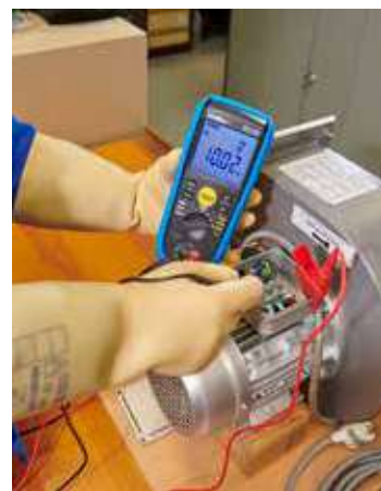
Maintenance préventive sur moteur
